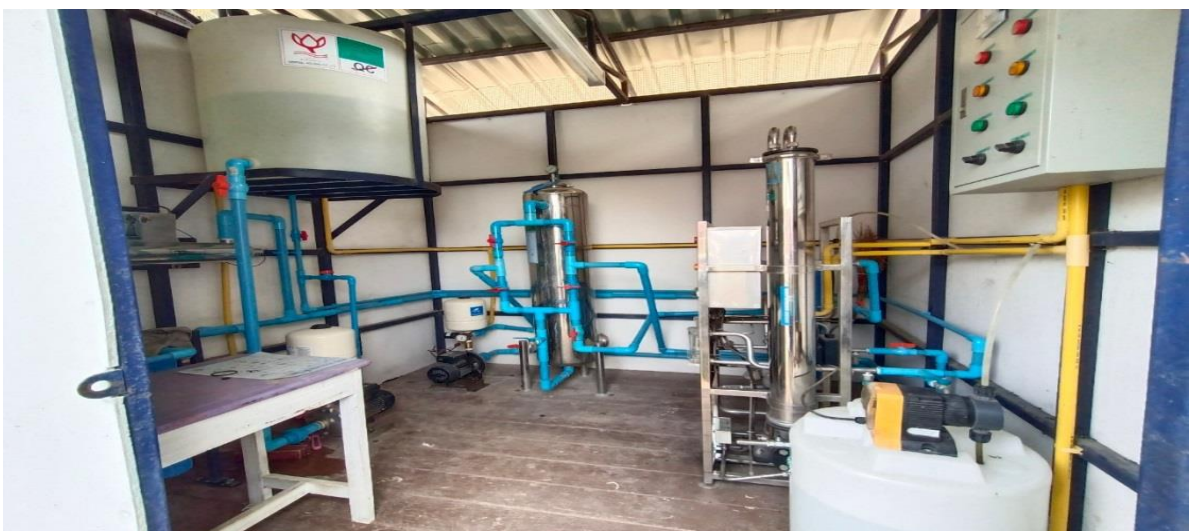
ระบบกรองน้ำ อยู่ในสภาพดี มีการทำความสะอาดอย่างต่อเนื่อง น้ำอุปโภค บริโภคผ่านเครื่องกรองน้ำใช้ในทุกกิจกรรมภายในโรงเรียน
